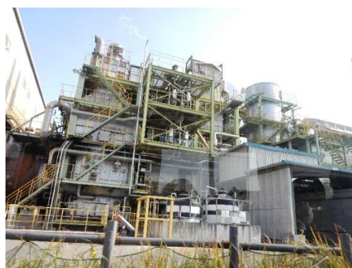
焼却施設（初号機）
